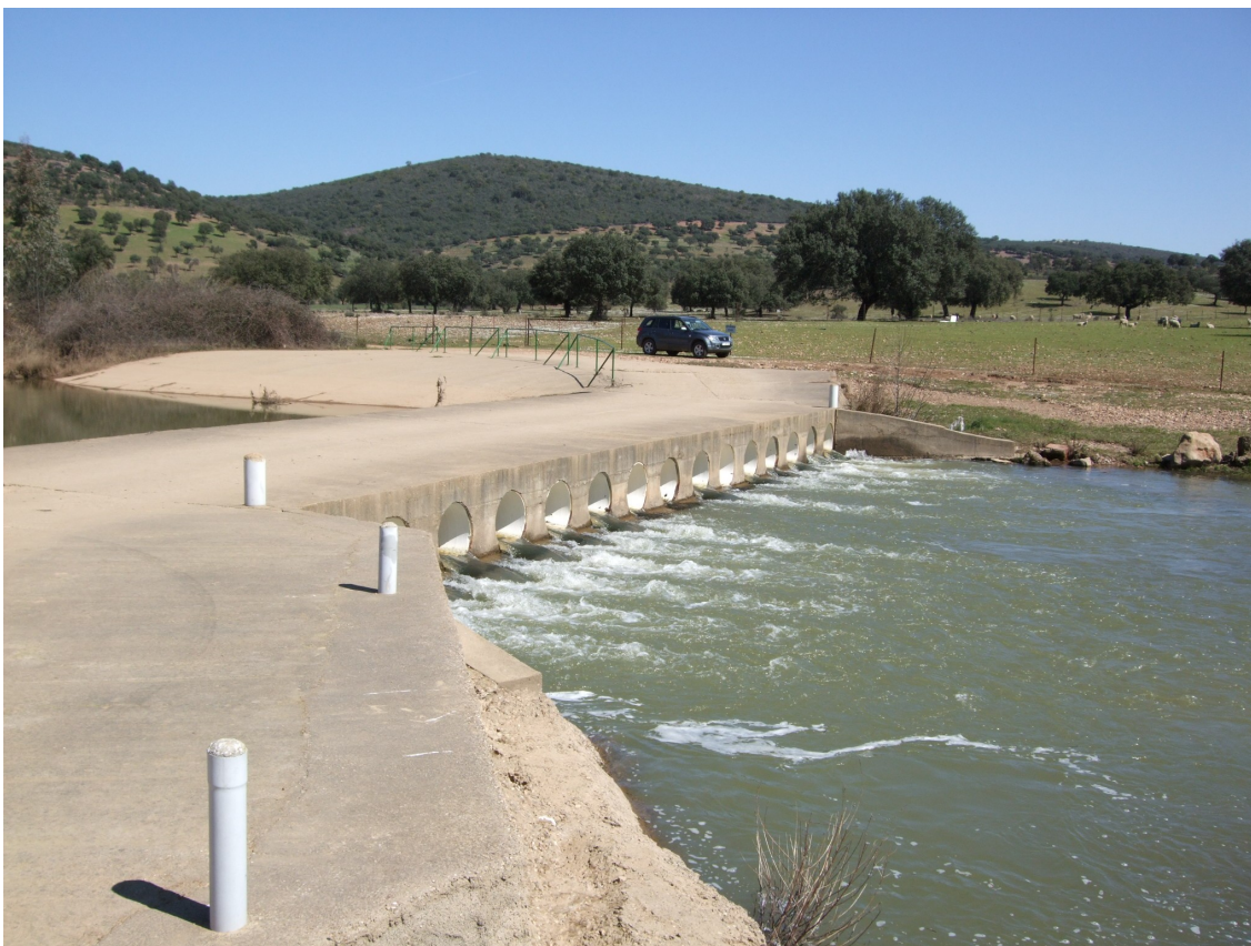
Obstáculo al remonte de los peces por la presencia de un badén de tubos en el río Guadalemar.
